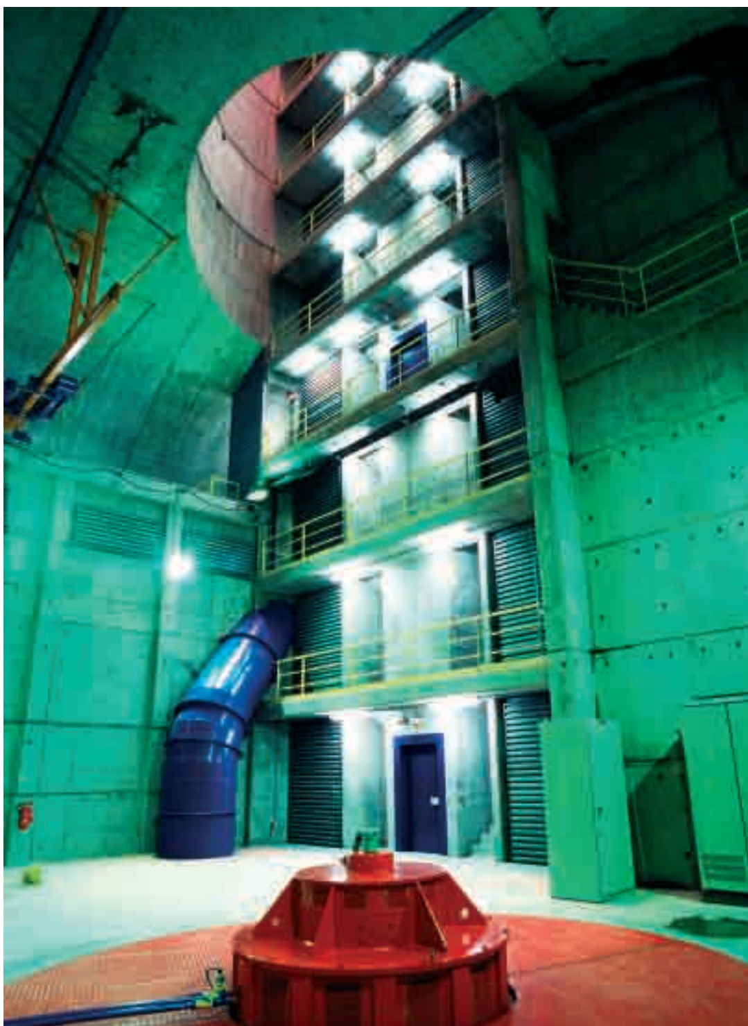
Interior de la central minihidráulica de El Villar
