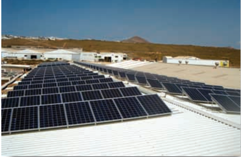
Instalación de 100 kW nominales sobre una cubierta industrial en Lanzarote puesta en funcionamiento por Lledó Energía Solar. La planta está compuesta por 483 módulos fotovoltaicos SolarWorld 210 W y dos inversores SolarMax 50 C.
