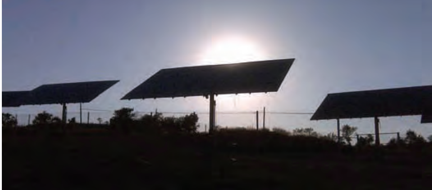
Arriba, campo fotovoltaico conectado a la red en Cervera (Lérida-España). Foto: ABKsolair.
