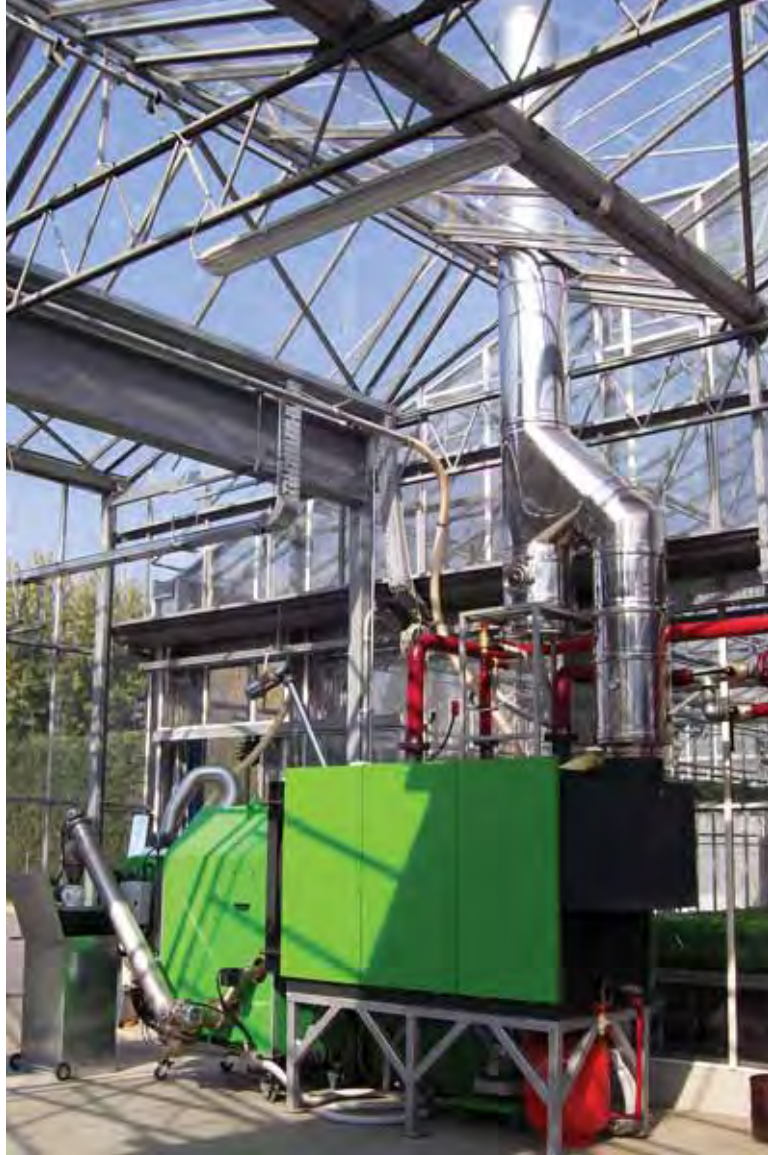
Caldera de gasoil en la que el quemador original ha sido substituido por un quemador sin cenizas Eneragro. La instalación está situada en Italia.
