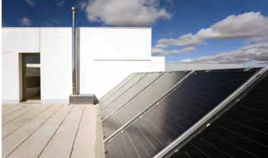
Arriba, detalle de la instalación solar del centro bioclimático del IES Miguel de Cervantes, de El Toboso. En la página anterior, paneles del CP Clara Sánchez, en Galápagos, Guadalajara.
