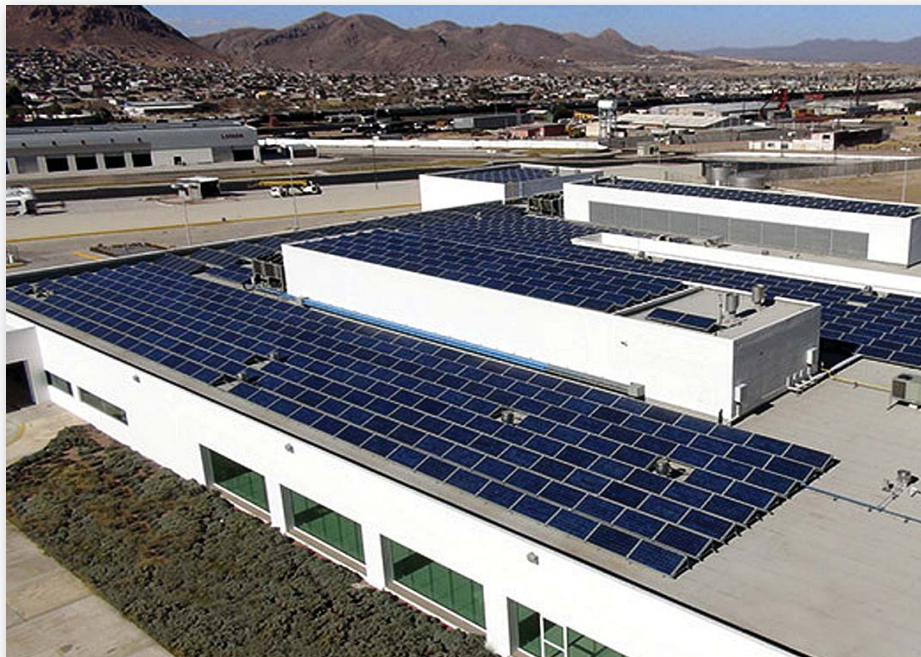
A finales de 2012, SunEdison completó los servicios de ingeniería y construcción de una planta fotovoltaica de 250 kW que abastece de energía eléctrica al nuevo Hospital Infantil de Especialidades de Chinchilla, en Chihuahua.
