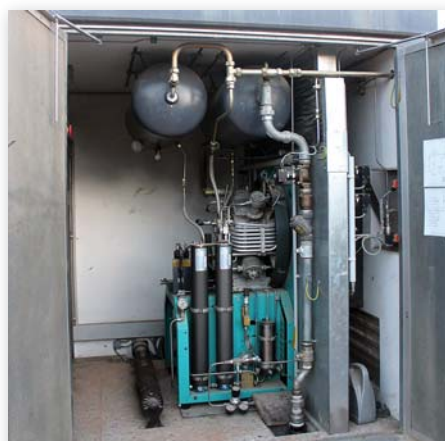
El área de suministro, con el sistema de compresión y la estación de suministro.
