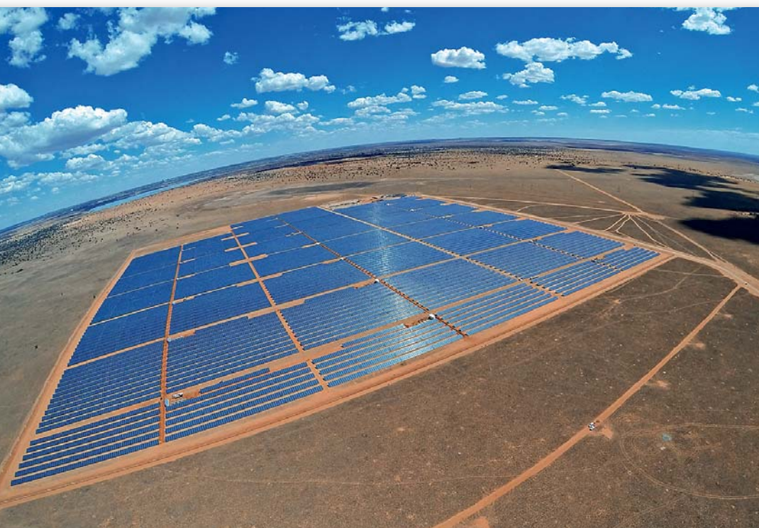
Parque solar Drogfontein en Sudáfrica.
