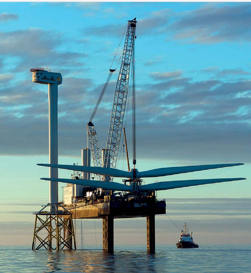
El European Offshore Wind Deployment Centre en el parque eólico de Aberdeen, Reino Unido
