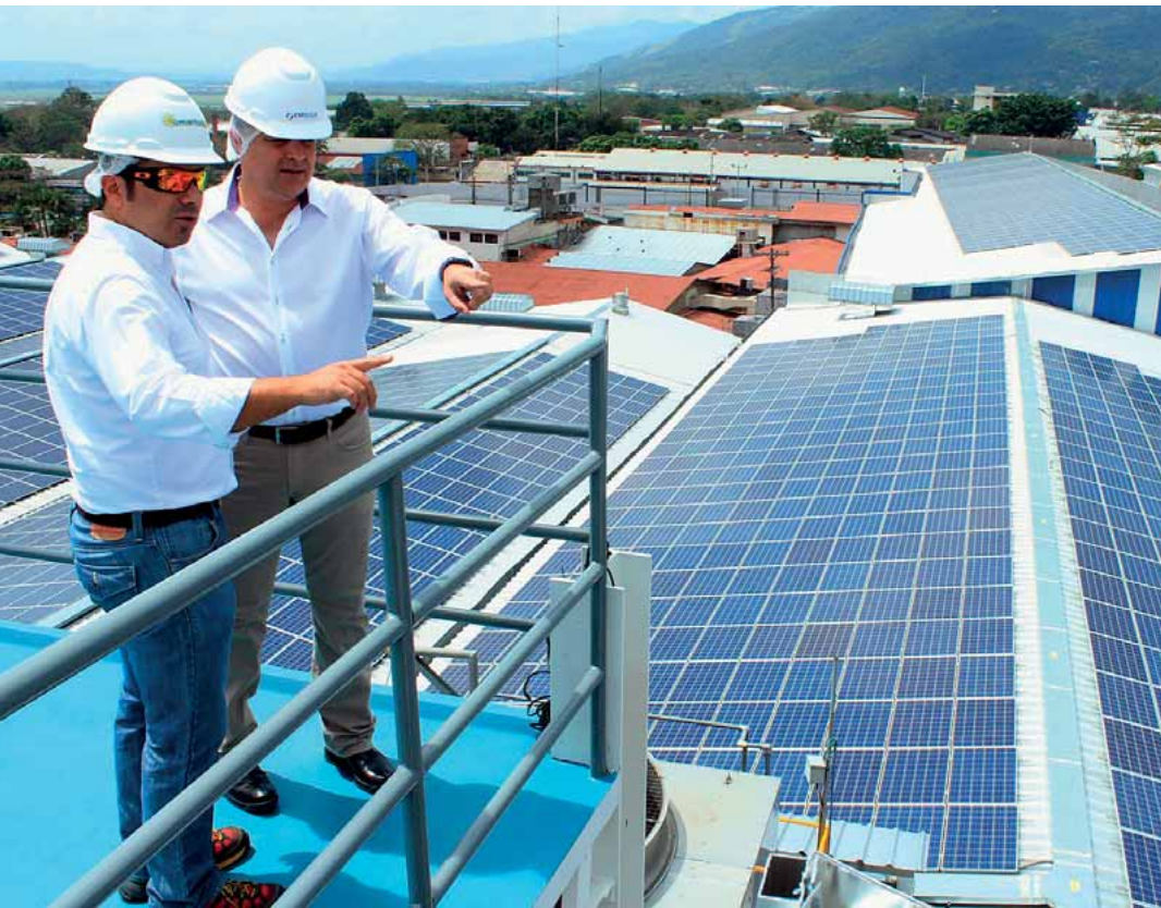
La cubierta de la embotelladora Emsula, en la localidad de San Pedro Sula, presentada como la mayor en Latinoamérica en su tipo.
