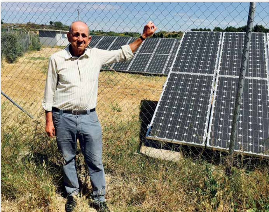
Junto a estas líneas, Custodio Buil, en su instalación solar, situada en Los Monegros. En la página siguiente, Ángel Miralda, y Jerry F.
