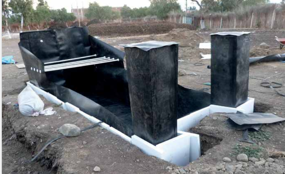
Momento de la instalación del biodigestor. Debajo, operación y comportamiento del biodigestor de Tiquipaya durante tres semanas.
