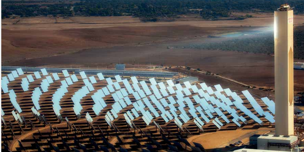
Central termosolar de torre central PS10 en Sanlúcar la Mayor (Sevilla).
