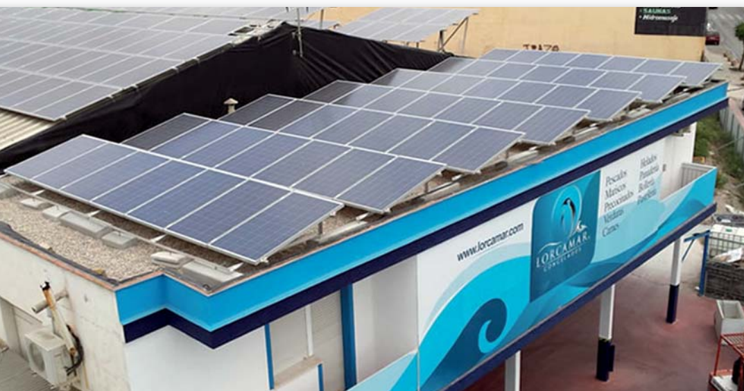
Arriba, una de las instalaciones para autoconsumo que ha puesto en marcha en los últimos meses la ingeniería Badia Energías, de Lleida. Abajo, la instalación de Lorcamar, un almacén de congelados cuya cubierta produce electricidad fotovoltaica desde julio de 2013. En la otra página, el Club Náutico L'Estartit, que empezó a generar energía solar en abril... de 2013.
