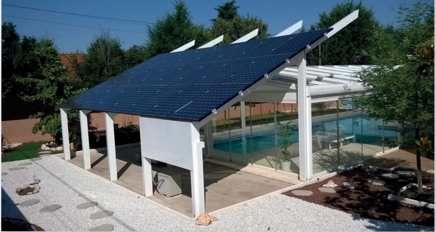
La instalación solar fotovoltaica de la vivienda de Raúl Caballero cuenta con 24 paneles y será ampliada próximamente a 30. Caballero, además, dispone de una instalación solar térmica.
