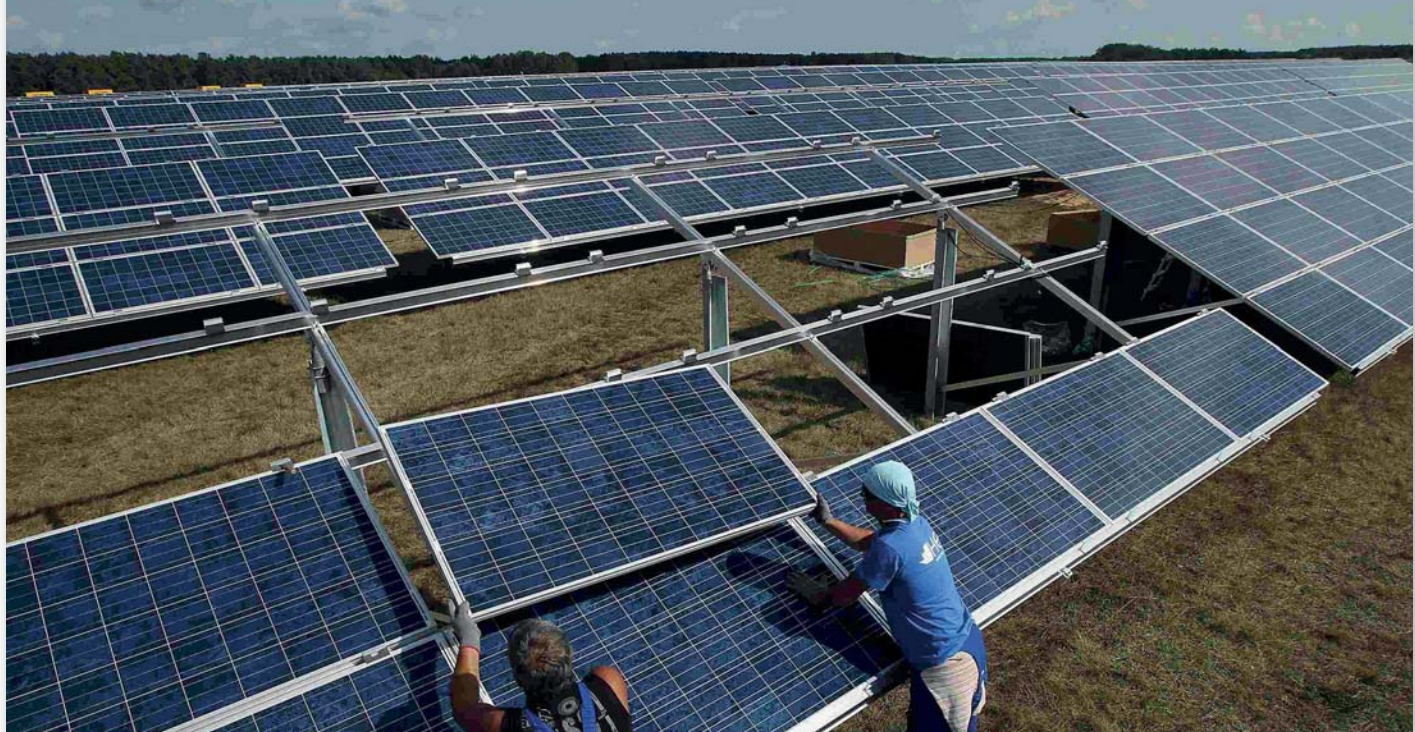
Instalación del parque de generación fotovoltaica "Cajeme Solar 10M", en Sonora. A la derecha, el parque fotovoltaico "Terrazas del Portezuelo".
