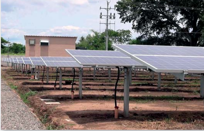
Instalación fotovoltaica en Puerto Jayaque, El Salvador. Abajo, parque eólico de Cerro de Hula en Honduras.
