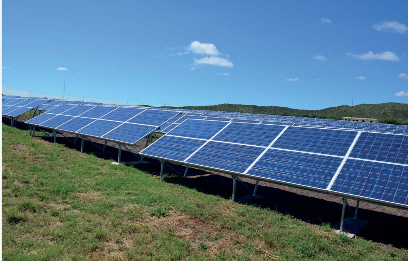
Parque Fotovoltaico Terrazas del Portezuelo.
