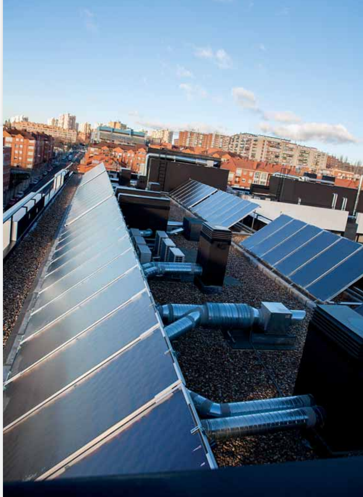
Proyecto de instalación térmica de referencia con equipos Viessmann en 87 viviendas en la calle Silvano de Madrid
