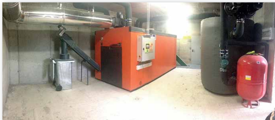
Bajo estas líneas, sala de calderas de la red de calor del barrio de La Girada, en Vilafranca (red que se alimenta de sarmientos).
