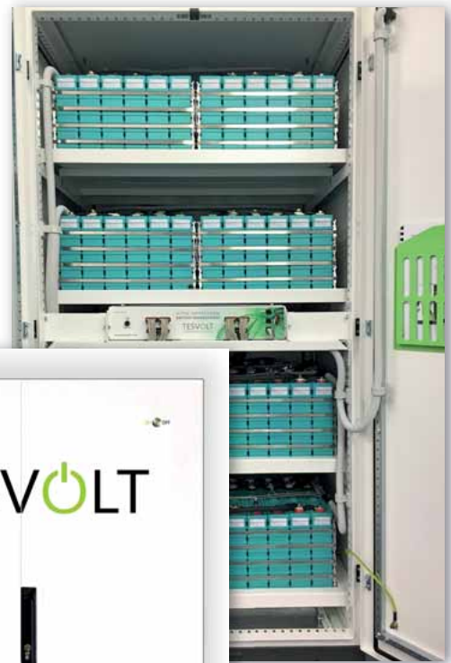
La instalación cuenta con 120 paneles fotovoltaicos policristalinos de Luxor Solar de 250 W, y un sistema de baterías de litio de 60 kWh de Tesvolt.
