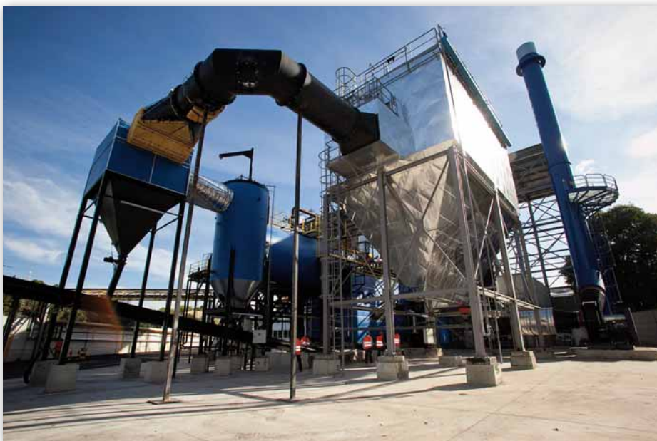
Instalación de LSole de 20 MW en Papelera de La Alquería, (Alicante)
