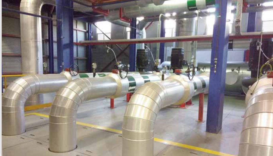
Detalle de la central de la red de distrito actual en Parc de l'Alba
