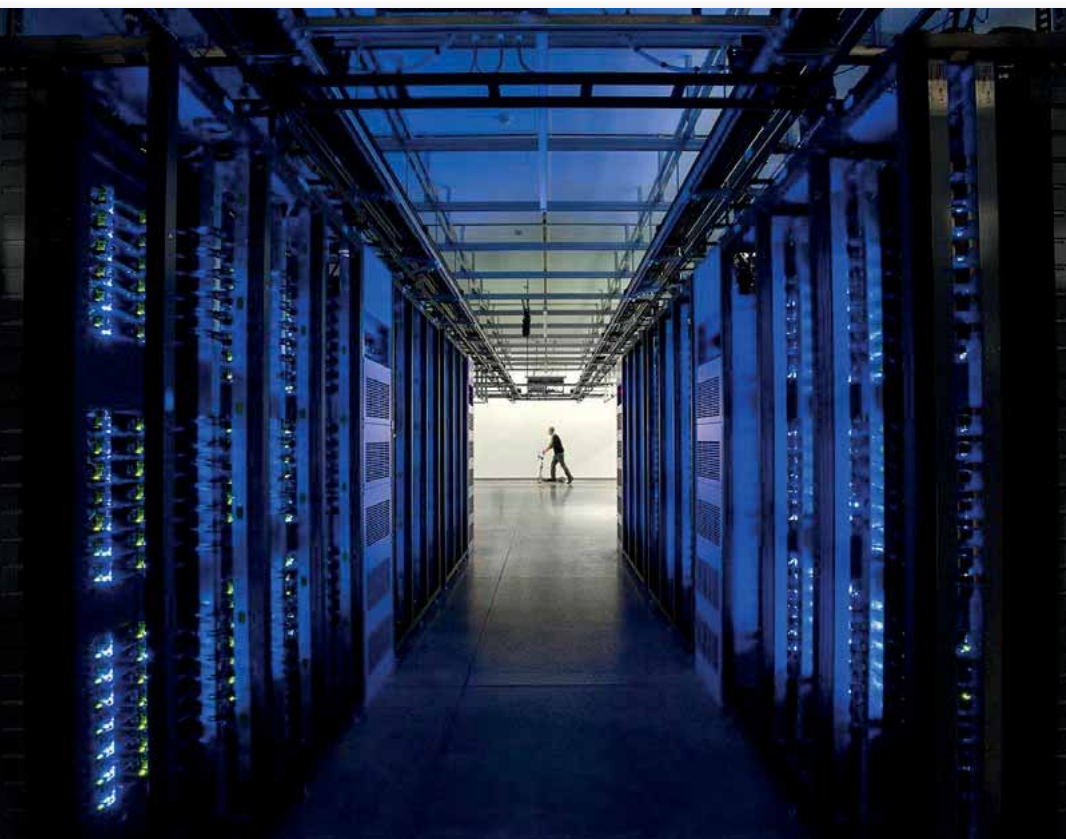
A la izquierda, el centro de datos de Facebook, en Altoona (Iowa, EE.UU.). En la página de la derecha, el de eBay en Utah (EE.UU.), que opera con pilas de combustible que almacenan electricidad generada con biogás.
