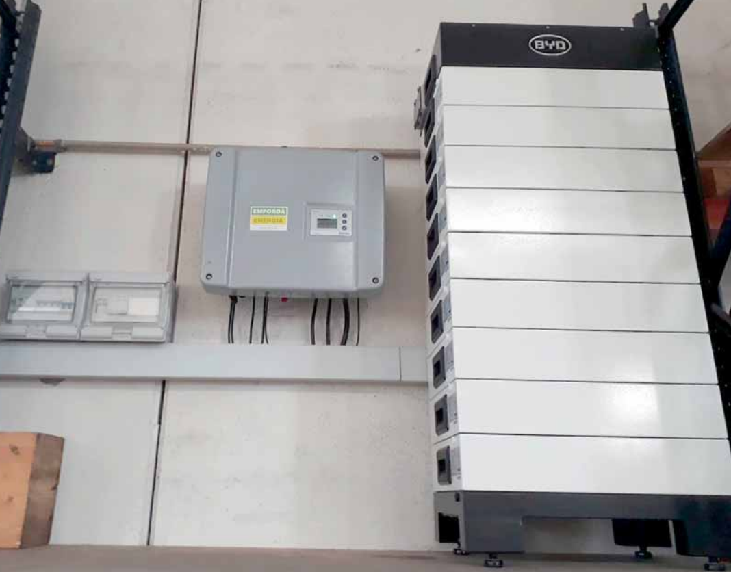
Instalación de autoconsumo con almacenamiento en la empresa Arico Forest. Cuenta con un inversor PIKO 6.0 BA de 6 kW, y una batería de BYD, con 9 módulos en serie que alcanza 11,5 kWh.
