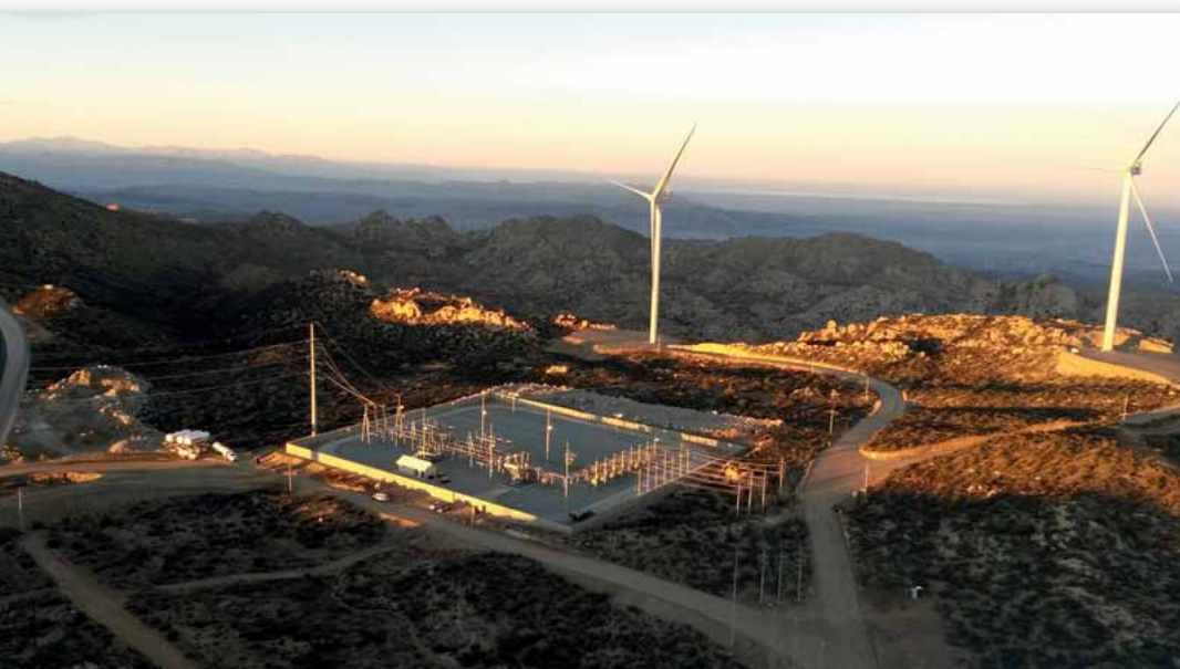
Parque eólico Energía Sierra Juárez, ubicado en la cadena montañosa de Sierra de Juárez y fronterizo con EEUU.
