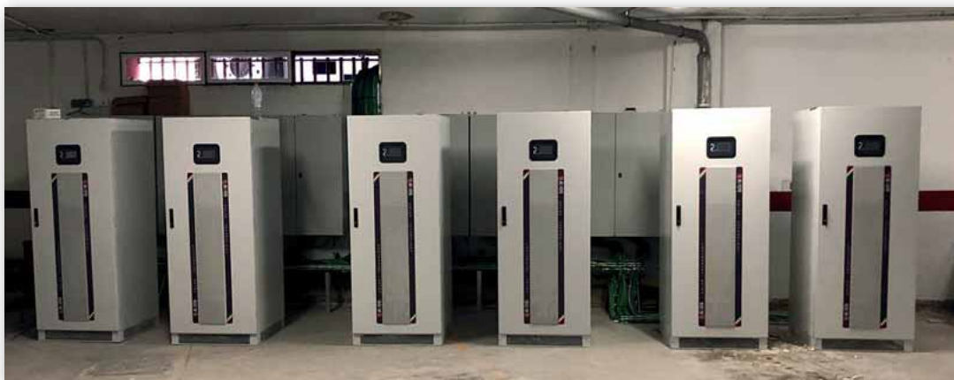
Seis de los nueve inversores de Aros Solar. En la página anterior, la cubierta fotovoltaica, de 1 MWp de potencia.
