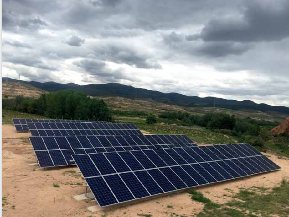
Bombeo solar de pozo a balsa de 54 kW en finca agrícola.
