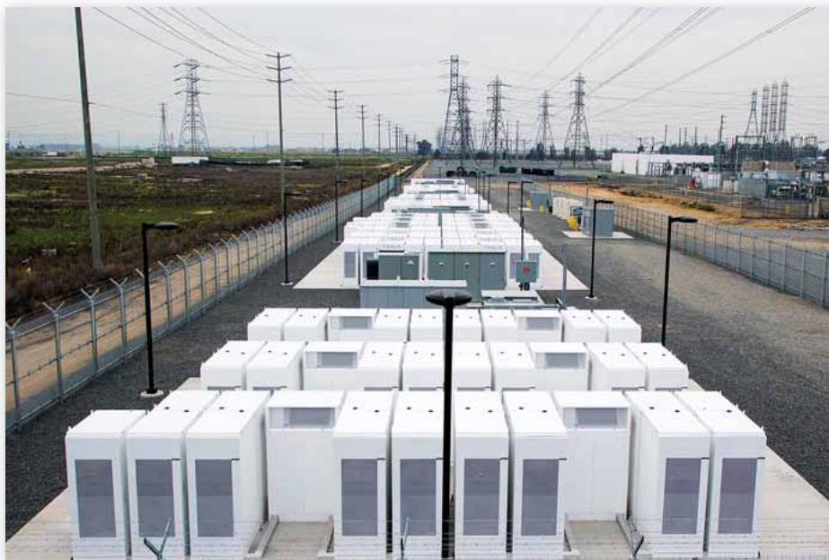
La nueva instalación de 20 MW con batería Powerpack en la subestación SCE Mira Loma, en Ontario (California).
