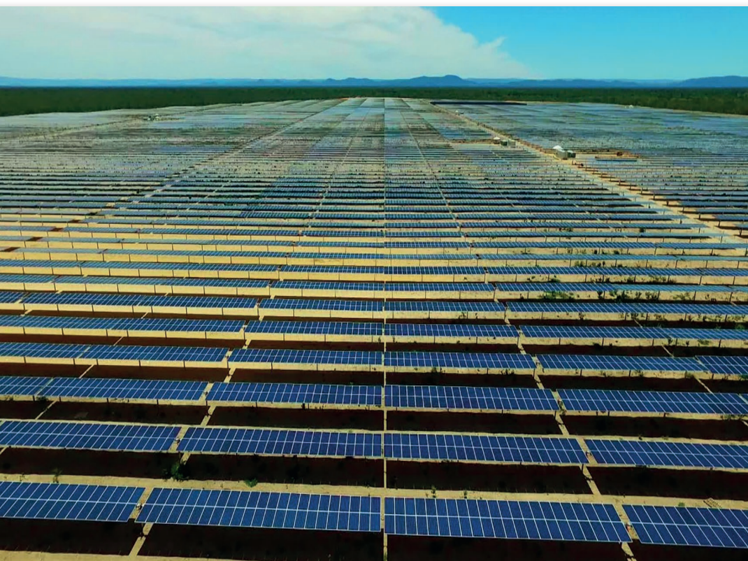
Lapa Solar Park. El parque solar está compuesto por las plantas Bom Jesus da Lapa de 80 MW y Lapa de 78 MW, tiene una capacidad instalada total de 158 MW
